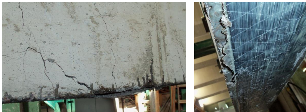
Figura 5. Rotura del refuerzo de fibras bajo carga puntual de viga V1
