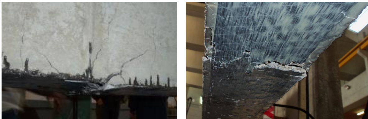
Figura 4. Rotura del refuerzo de fibras bajo carga puntual de viga V1
