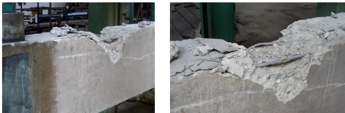
Figura 6. Falla por compresión del hormigón de viga V5 (refuerzo de fibras de vidrio intacto)
