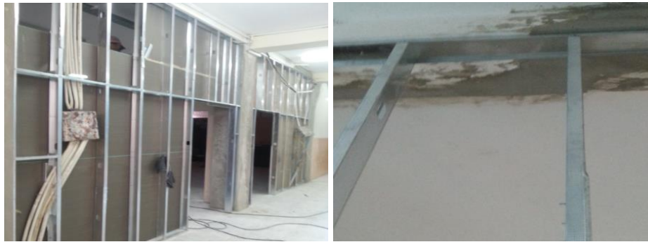
Figura 12. Colocación de estructura de Gypsum: a) elementos horizontales e instalaciones eléctricas; b) pernos de sujeción en la losa colocados con tacos.
