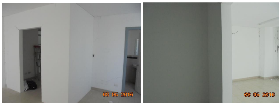
Figura 7b. Comportamiento de paredes Gypsum en Edificio Fortaleza. Fuente: Aguiar y Del Castillo [8]
