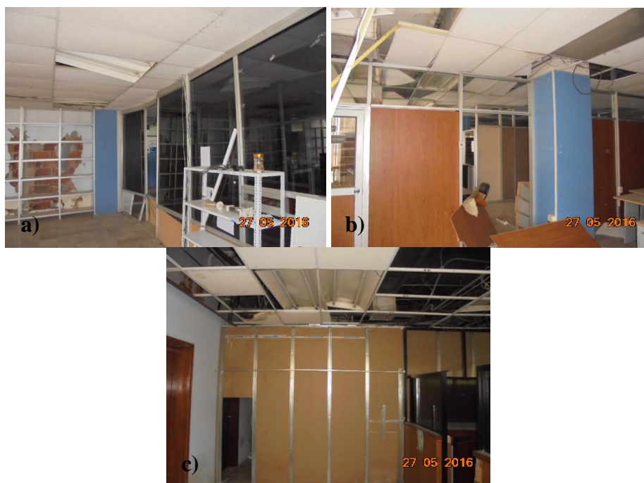
Figura 9. Construcción de paredes en Edificio del Banco Central ubicado en Manta; a) pared sin junta de construcción; b) rotura de panel de madera; c) caída de uno de los recubrimientos de la pared.
