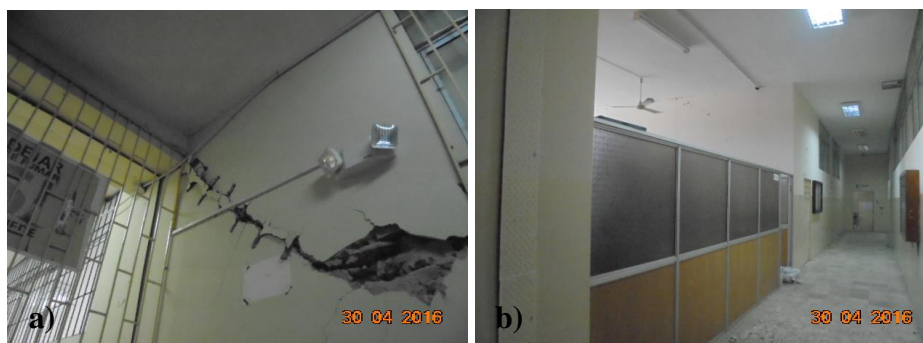
Figura 8. Desempeño de paredes en Facultad de Ciencias de la Salud de la UTM; a) pared reforzada con varillas de acero en forma de “C” luego del terremoto del 4 de Agosto de 1998; b) pared con material muy liviano que no presentó daño durante el terremoto de 2016.
