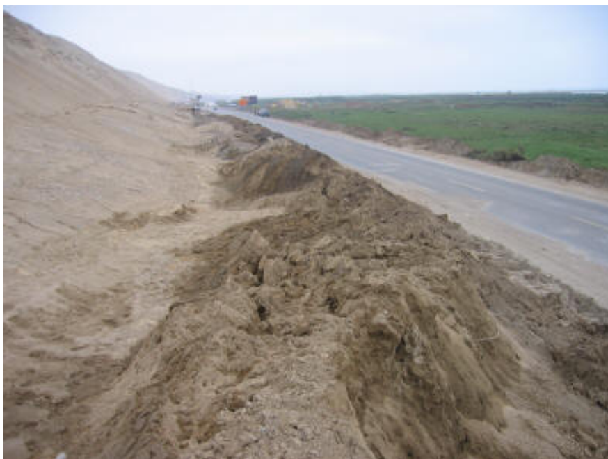
Figura 24: Avalancha de suelo en la carretera Panamericana.
