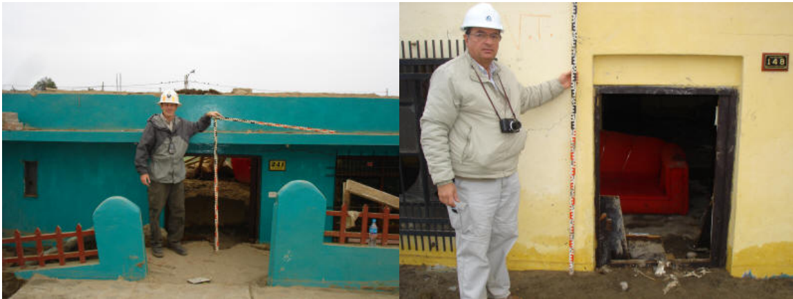
Figura 19: Asentamientos de aproximadamente 0.9 m en Tambo de Mora.
