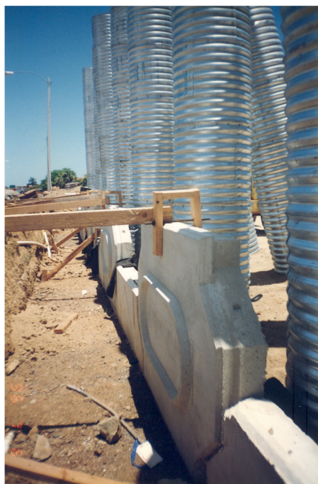
Figura 10: Estribo norte con tubos corrugados para reducir fricción negativa por el relleno. En el segmento del pilote debajo de la elevación ilustrada ocurriría fricción negativa sobre el pilote.
