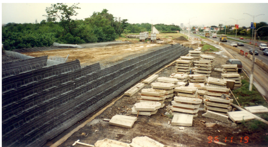
Figura 9: Vista de rampa suroeste y muro con mallas de alambre. A la derecha se notan los paneles de hormigón que finalmente formarían la fachada del muro. Estos se colocaron luego de ocurrir la mayoría de los asentamientos.
