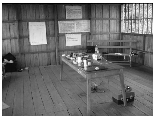
Figura 4: Aspecto de los tableros eléctricos y materiales adicionales utilizados en el curso de capacitación. [Foto: André Mocelin]
