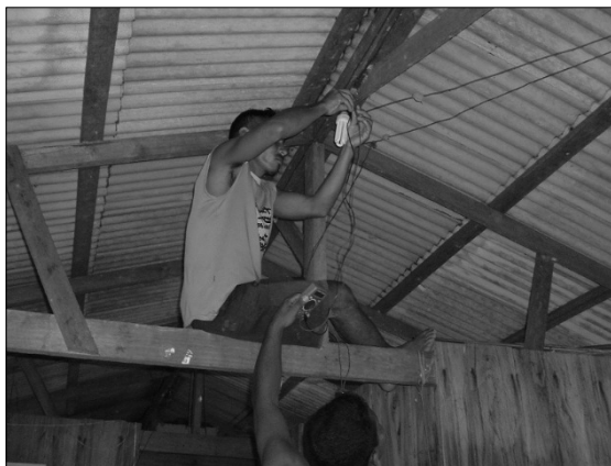
Figura 6.:Técnico de São Francisco do Aiucá midiendo la tensión eléctrica en la instalación fotovoltaica domiciliar. [Foto: André Mocelin]
