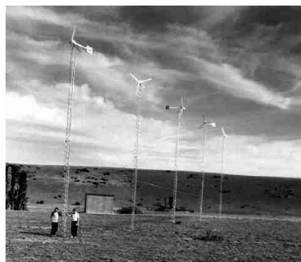
Figura 2 – Equipos eólicos instalados (SPSE/CFI)
