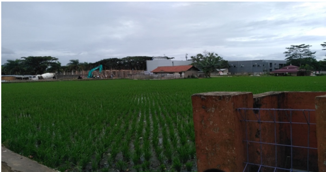
Gambar 1. Pembangunan Gedung yang Sedang Berlangsung di Area Kota Baru Parahyangan Sumber: Dokumentasi Peneliti, 2018.
