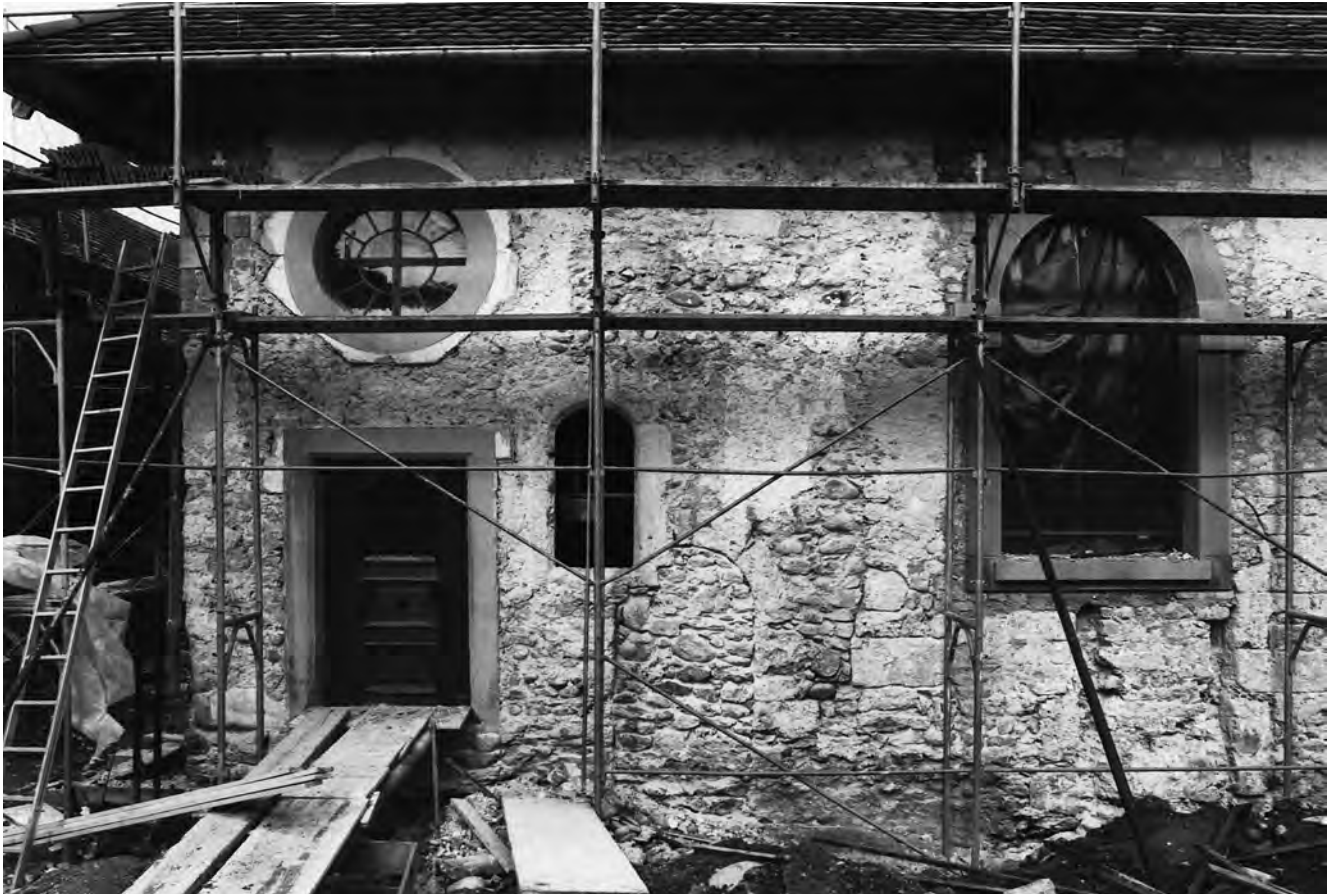
Abb. 237: Meikirch - Kirche 1977. Südfassade des Schiffes. Die Baunaht zwischen der romanischen Kirche (Mauerwerk mit Eckquadern) und der Verlängerung ist gut sichtbar. Blick nach Norden.
