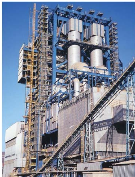
Figura 2.9: Caldera tipo Foster de la C.T. de La Robla -Grupo I
