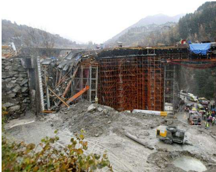
Fig. 1.2. Accidente en un paso superior cimbrado
