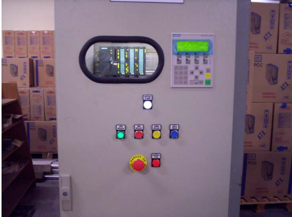
Figura 1. Puerta Armario Eléctrico.
