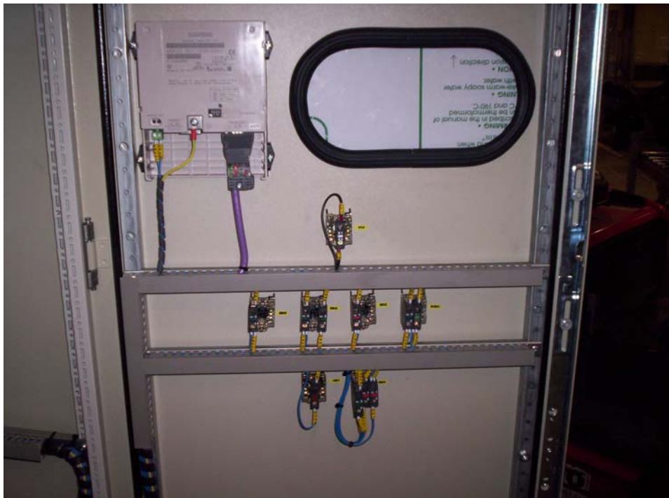
Figura 2. Interior Puerta Armario Eléctrico.
