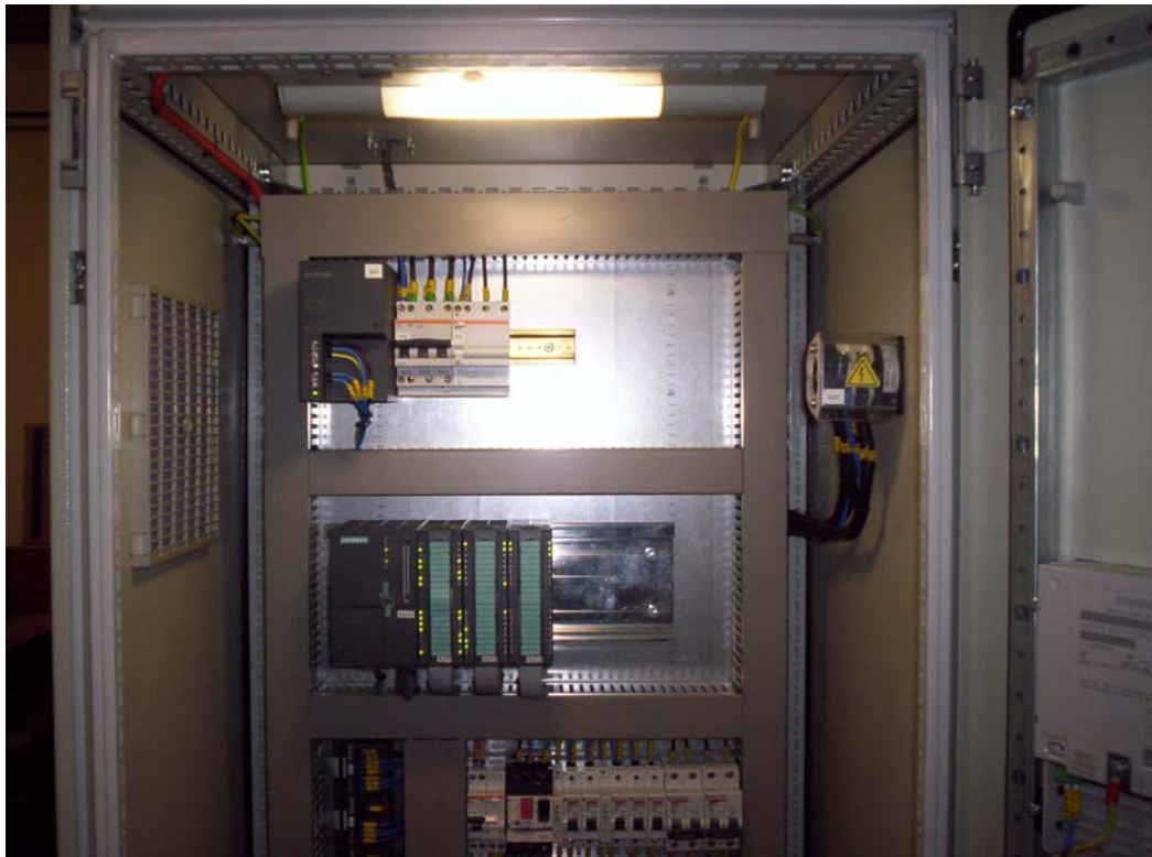
Figura 3. Interior Armario Eléctrico.
