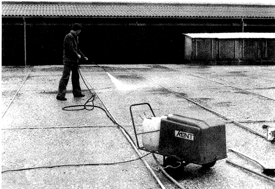
Het reinigen van de oude verharding met behulp van een hogedrukspuit. Cleaning of the old pavement with a high pressure cleaner.
