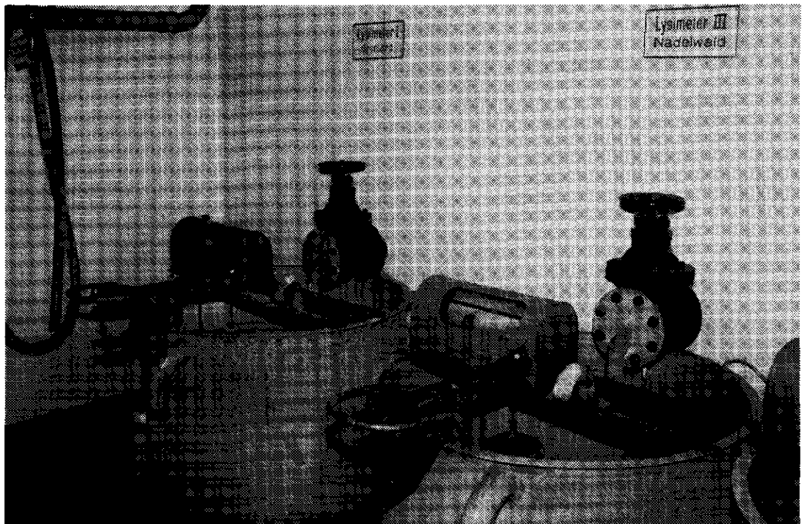
Meetopstelling voor het drainagewater
