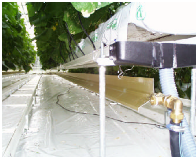
Figuur 4-6 Foto van de speciale aluminium buis onder de hangende teeltgoot.
