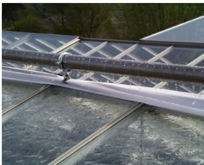
Figuur 3-7 Dakbevoeiingssysteem om warmte aan het kasdek te onttrekken.
