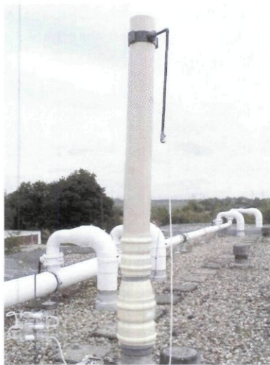
Afvoerpijp voor bepaling van luchtdebiet en methaan- gehalte.
