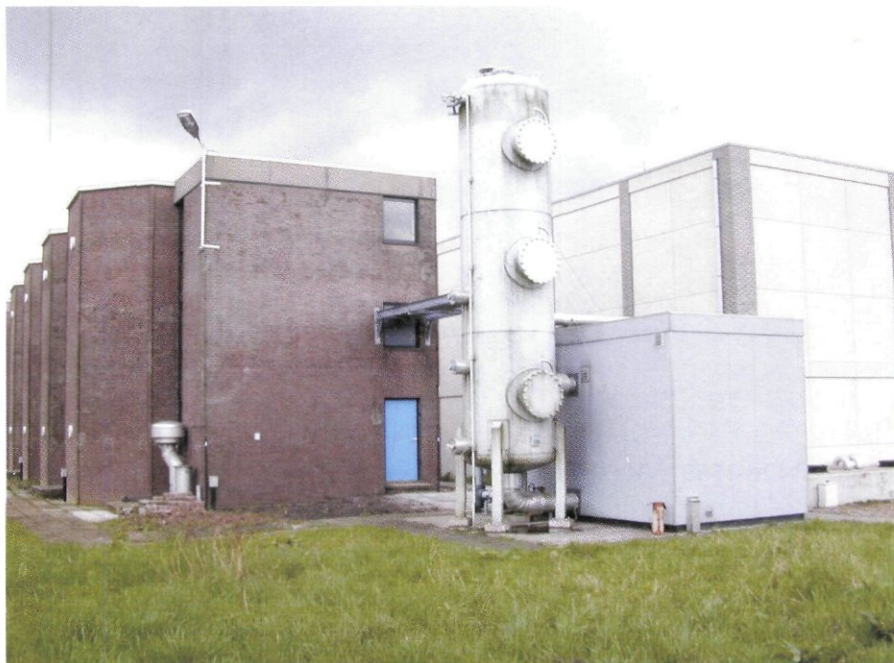
De vacuüminstallatie van zuiveringsstation Lekkerkerk.
