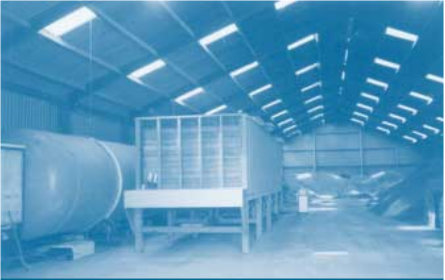
Figuur 2 Voorraadbunker en composteertrommel
