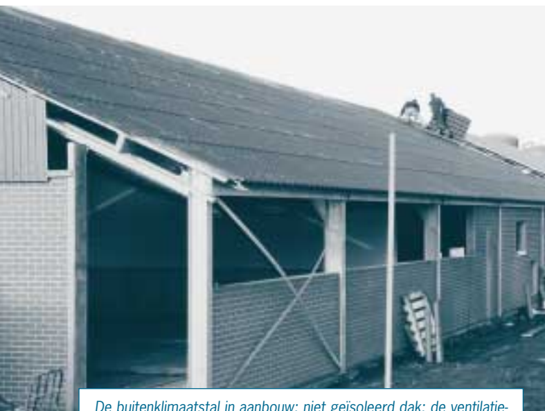
De buitenklimaatstal in aanbouw: niet geïsoleerd dak; de ventilatie-openingen zullen van een regelbaar gordijn worden voorzien
