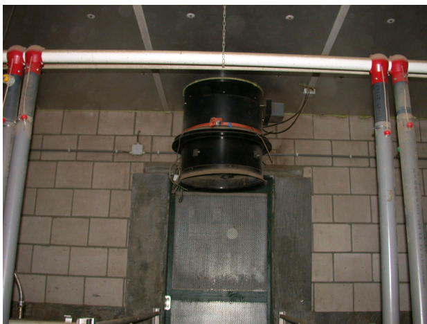
Figuur 3 Debietbepaling met behulp van een meetventilator die geplaatst is in een aangebouwde koker met gelijke diameter als de koker in de stal.
