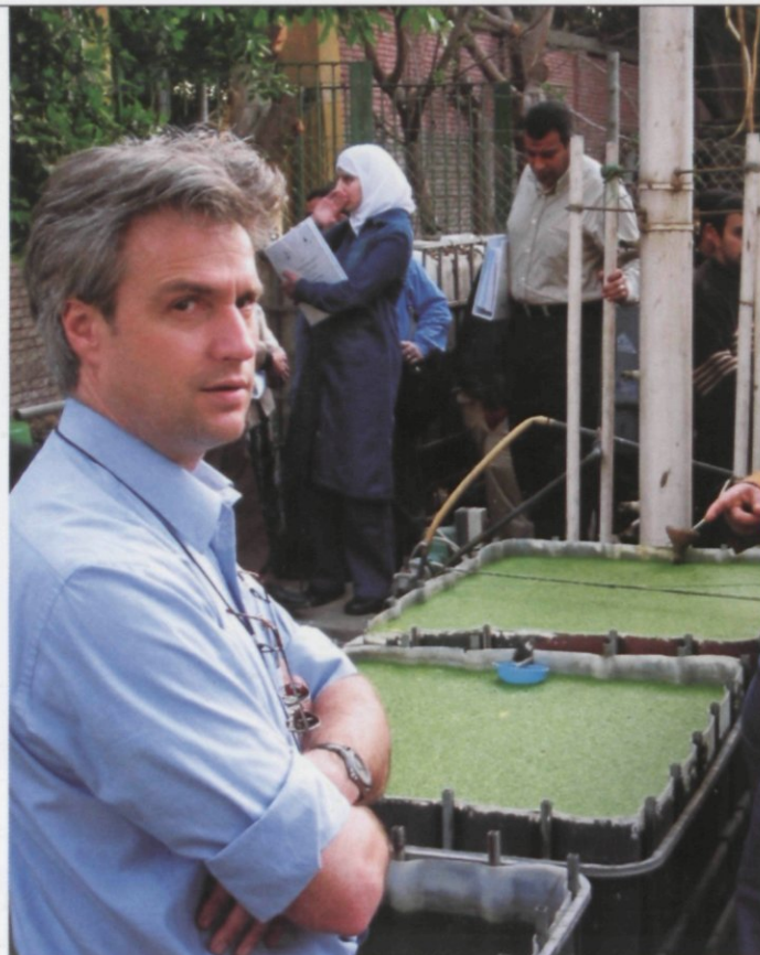
Proefinstallatie van een UASB-reactor (buis op de achtergrond) en twee bakken met eendenkroos voor stikstof terugwinning. Cairo, Egypte.
