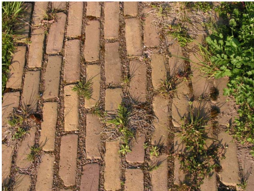
Klinkers met afstandhouders (KA), twee jaar na aanleg.
