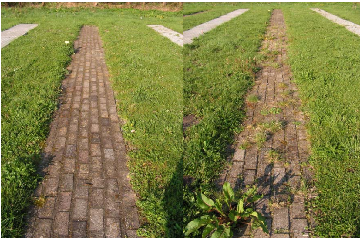
Geomix voegvulling (BKG, links), twee jaar na aanleg en bestaande klinkers met split (BKS, rechts).
