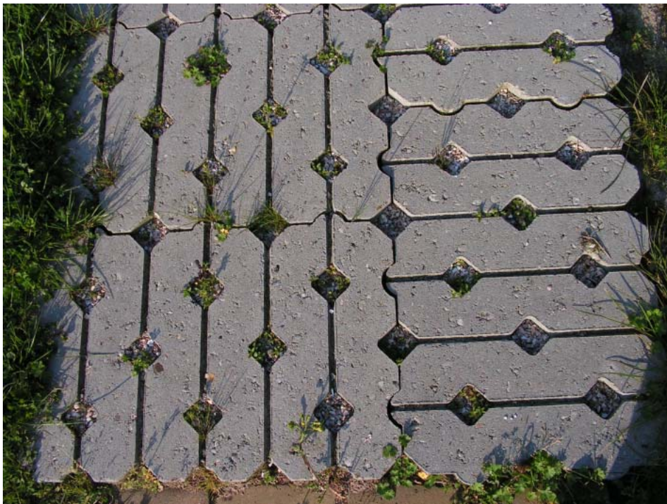
Rona blocks (RB), twee jaar na aanleg.
