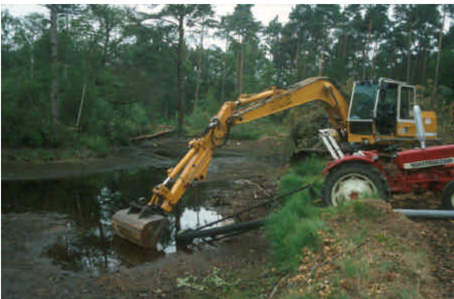
Foto 36 Met een graafmachine kan veel nauwkeuriger gewerkt worden en kan het aanwezige reliëf beter worden gevolgd dan met een baggerboot. (foto: H. van Kleef)
