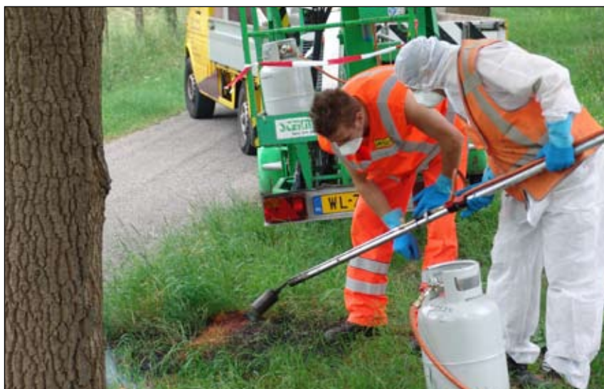
Een voorbeeld van volledig onbeschermd werken. Zo moet het dus niet (Kuppen Boomverzorging, Mill)
