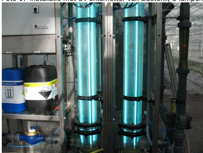
Foto 1. Installatie met UV-ontsmetter van Bactokil, 3 lampen in een doorzichtige reactor
