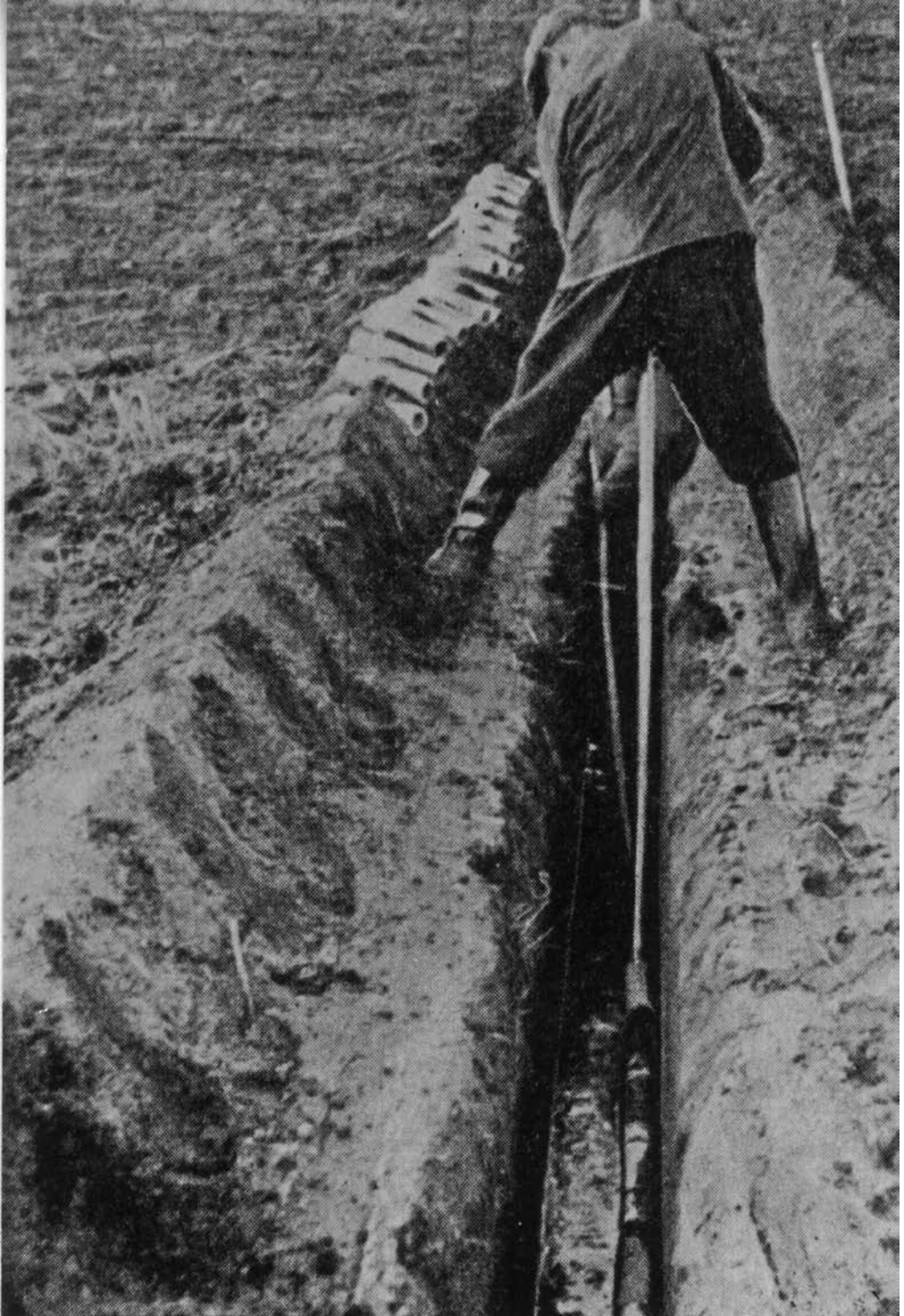
Figuur 7: Het leggen van drainbuizen volgens de 'Zeeuwse methode' (Foto uit: Janert, 1961).
