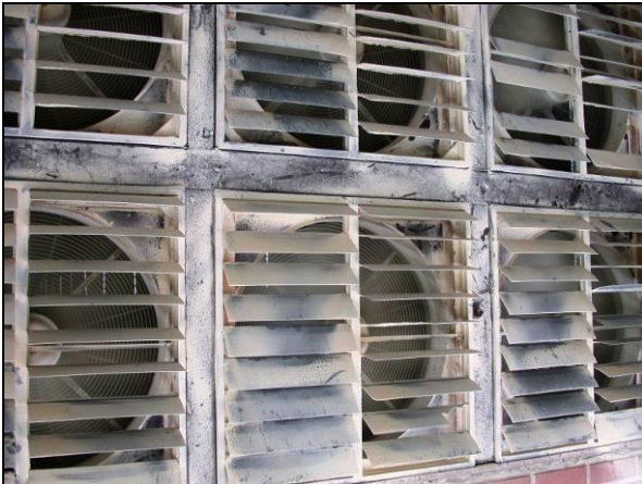
Ventilatoren in de achtergevel, onder de lichtklep
