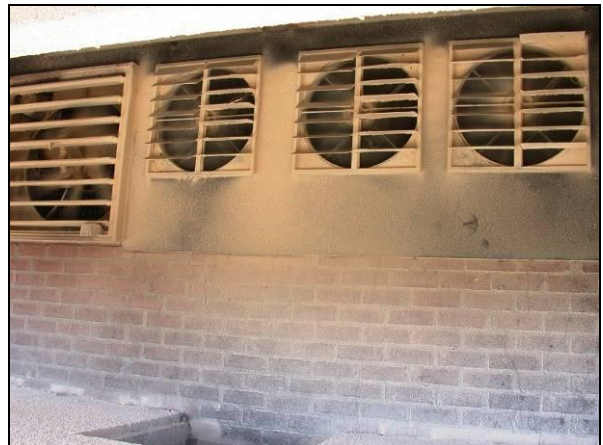
Ventilatoren in de buitenmuur onder de lichtklep
