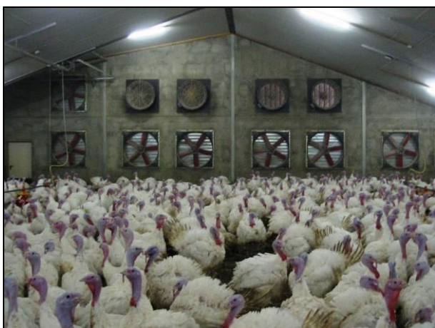
Ventilatoren in de kopgevel
