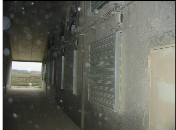
Buitenzijde luchtuitlaat; ventilatoren in de achtergevel
