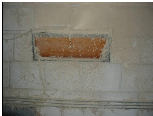
Binnenzijde inlaatventiel in zijgevel
