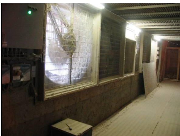
Binnenzijde ventilatoren voor de uitgaande lucht
