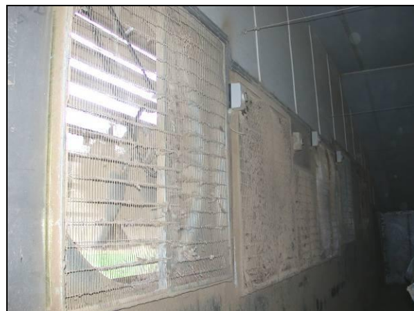
Binnenzijde ventilatoren voor de uitgaande lucht
