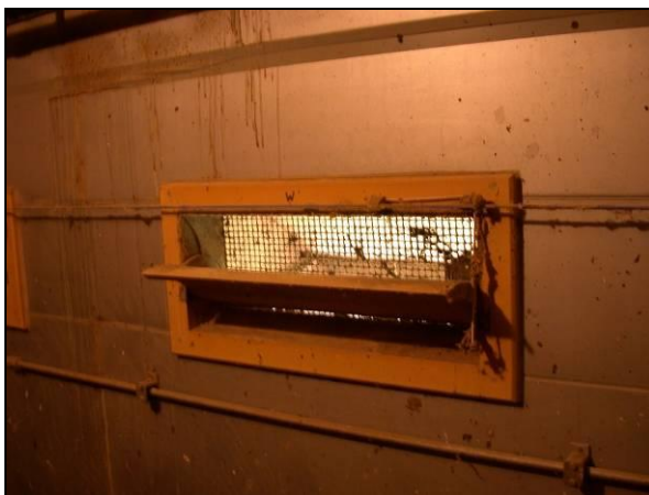
Binnenzijde inlaatventiel in zijgevel
