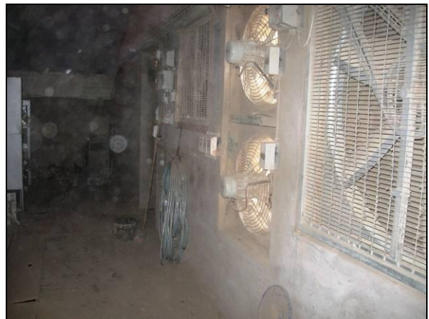
Binnenzijde ventilatoren voor de uitgaande lucht
