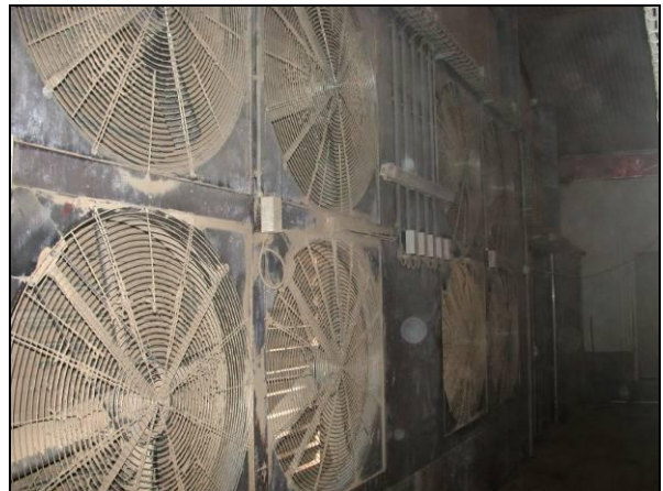
Binnenzijde ventilatoren voor de uitgaande lucht
