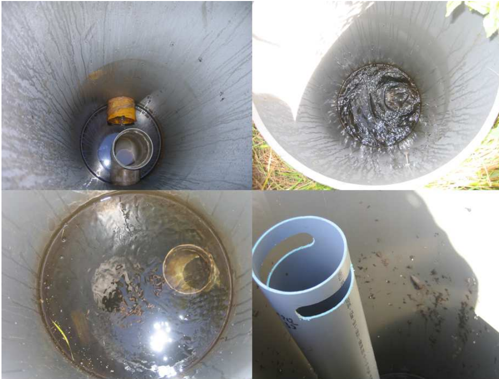
Fotocollage 41 Bezoek aan agrariërs - impressie putten inwendig (6) – linksboven een enkelvoudige put; rechtsonder detail van een verticale regelpijp waarmee de drainageintensiteit kan worden geregeld; de uitsparingen zijn handgrepen; rechtsboven en linksonder zijn putten te zien waarin water van elders wordt aangevoerd; dit water kan via de verzameldrain naar de draineerbuizen worden geleid, waarna het ondergronds in de bodem kan infiltreren.
