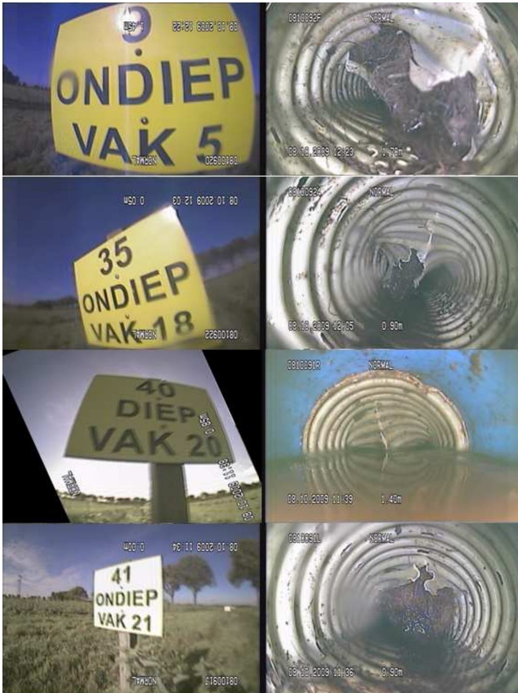
Fotocollage 17 Inwendige inspectie van draineerbuizen: voorbeelden van beschadigingen aan de buiswand waardoor omhullingsmateriaal naar binnen komt en de hydraulische werking ernstig wordt gehinderd. Deze vorm van beschadiging lijkt structureel, want is geregeld vastgesteld, ondanks het geringe aantal geïnspecteerde drains (ca. 1/3 van alle aanwezige drains).
