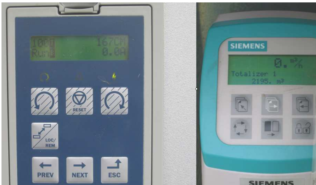
Fotocollage 13 links: controle-eenheid voor de automatische regeling van de pompinstallatie; de waterspiegel is er gesteld op 167cm boven een referentiepunt; rechts: controle-eenheid
