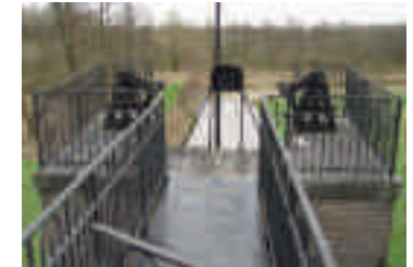
Sluis van de Nieuwe Zuider Lingedijk
