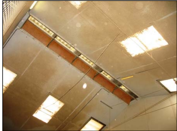
B. Plafond afdeling Big Dutchman met ionisatie
