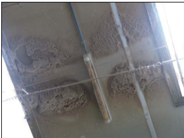
E. Detailfoto van stofophoping aan het plafond rondom de coronadraad
