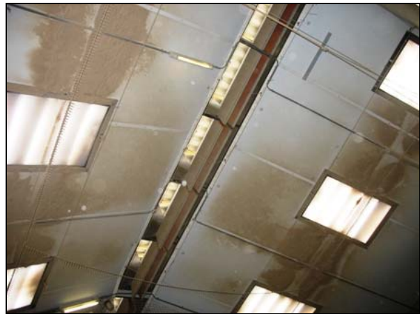
D. Plafond afdeling Meller met ionisatie
