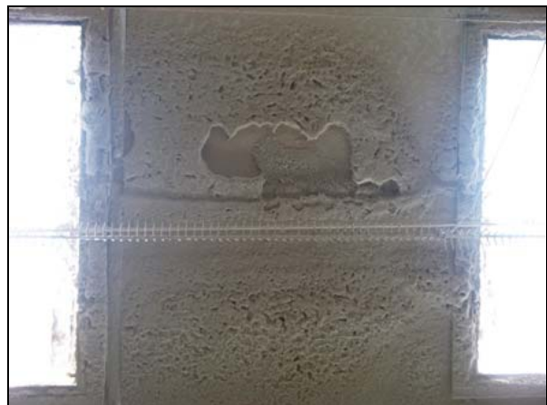
F. Detailfoto van stofophoping aan het plafond rondom de coronadraad
