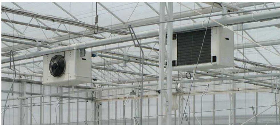
Figuur 15. Foto van twee van de zes koelers in de SunergieKas. De linker koeler toont de blaas-zijde en de rechterkoeler toont het warmtewisselaar oppervlak aan de zuigzijde. De koelers hangen op 6.5 meter hoogte.
