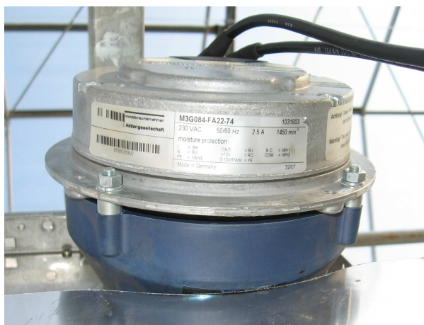
Figuur 6. Detailfoto van de ventilatormotor op de OPAC106 warmtewisselaar
