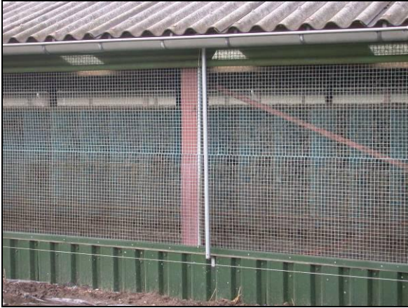
Luchtinlaat met vogelgaas (plafondventilatie)
