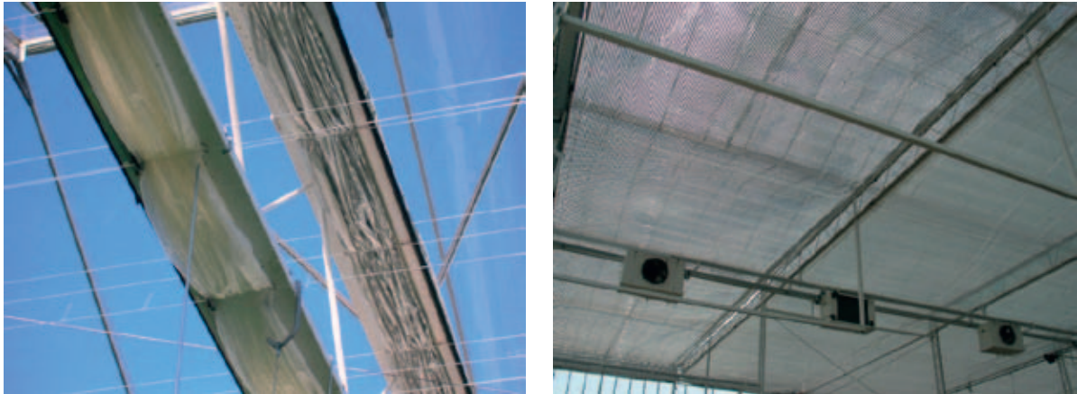
Figuur 2. Links Het energiescherm (l) en het zware isolatiescherm (r), gebruikt voor de reductie van het energiegebruik. Rechts Dicht energiescherm met de koelunits.
