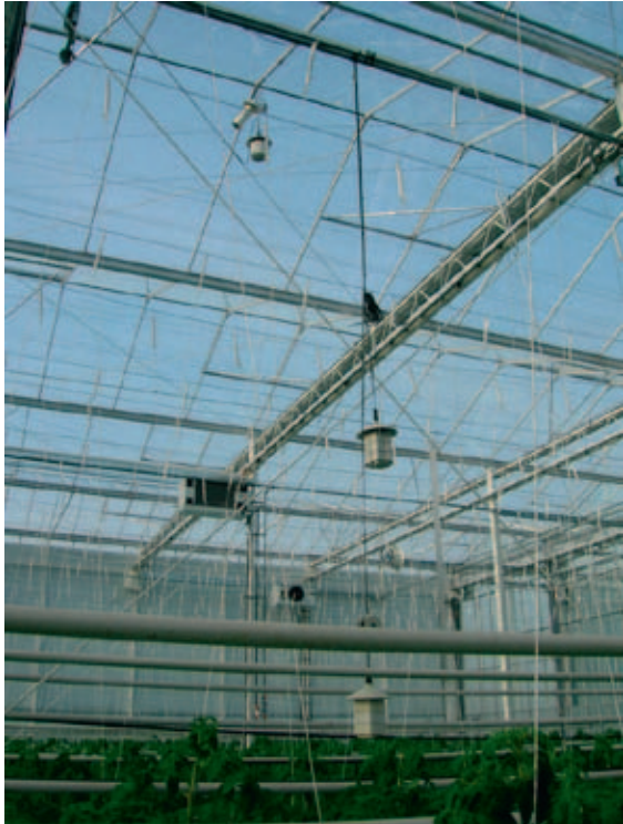
Figuur 5. Drie meetboxen geïnstalleerd op één locatie.
