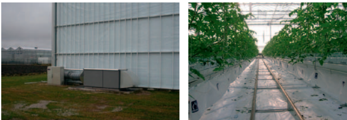
Figuur 3. Links - De luchtbehandelingkast buiten de kas om lucht aan te zuigen voor gecontroleerde ventilatie. In de luchtbehandelingkast zit een ventilator en een warmtewisselaar. Rechts – de luchtverdeelslangen onder de goot.
