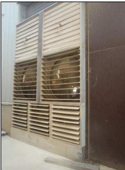
Ventilatoren in achtergevel
