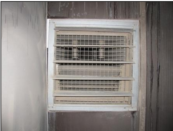
Uitstroomzijde ionisatiefilter (in het meethuisje)
