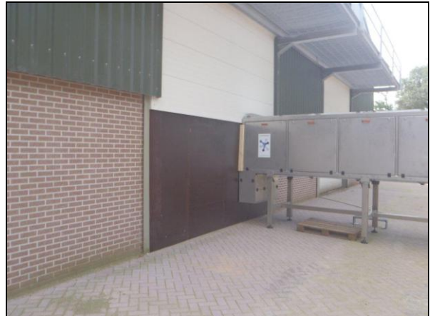
Positionering ionisatiefilter tegen voorgevel
