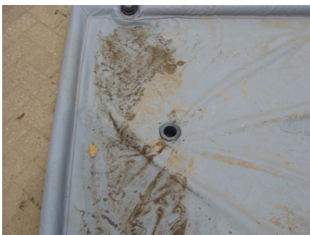
Foto 4: De originele water afvoer (linksboven) en het nieuwe waterafvoerpunt (midden) in de wasplaats
