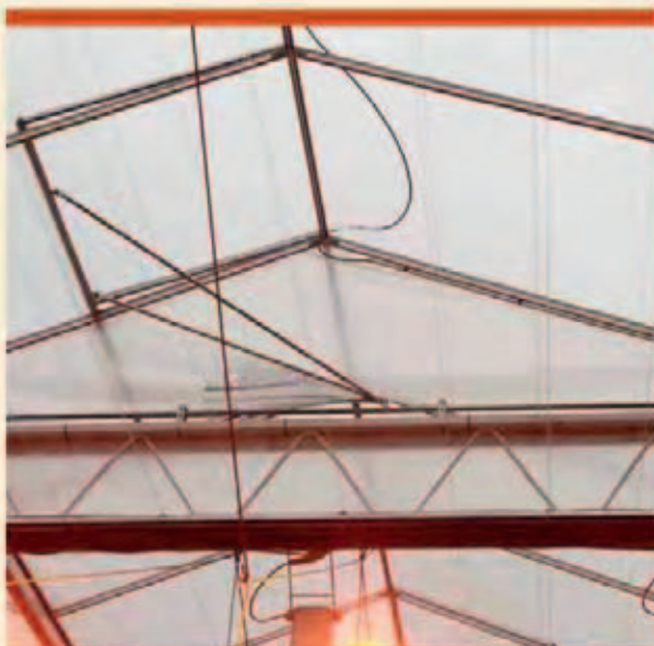
Boven het scherm zijn over de lengte van de kap op gelijke afstand van elkaar twee plastic afdekkingen gemonteerd om de luchtstroom te stoppen.
