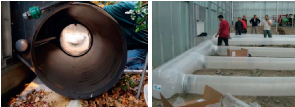
Figuur 2.5. Inkijk in de luchttrommel (links) en de hoofdverdeelslangen.
