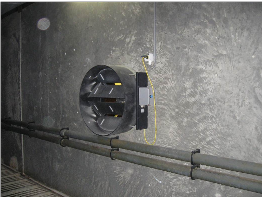
Luchtuitlaat stal naar centraal afzuigkanaal
