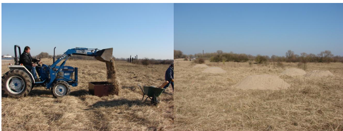
Figuur 4: Links: het plaatsen van de bekistingen en afvullen met zand, rechts: het eindresultaat.
