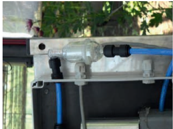
Detail opname filter voor aanvoer naar drainteller.
