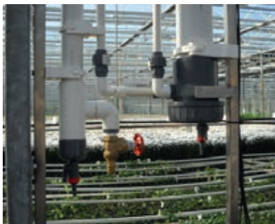
Voorziening voor afvoer drainwater aan kolom na meting.
