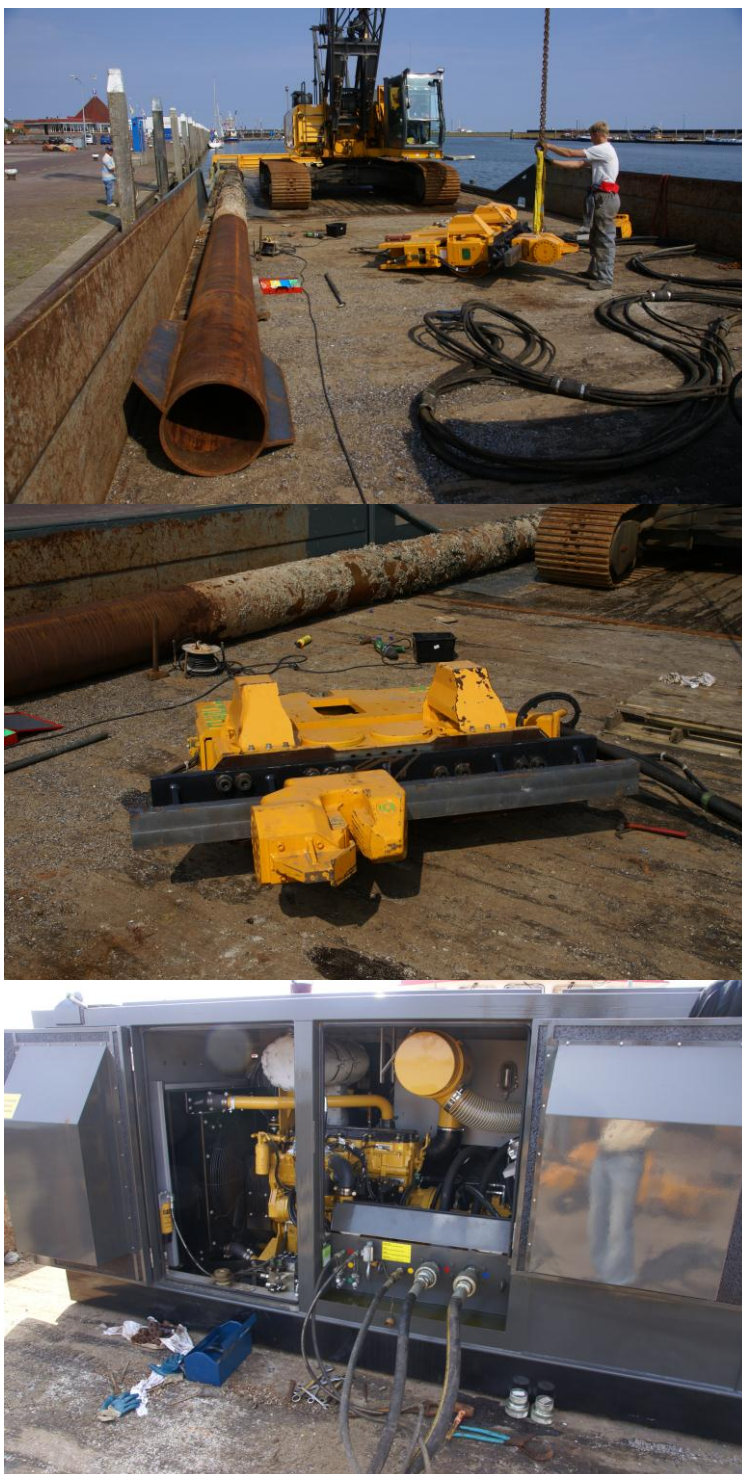
Figuur 9 Overzicht paalanker en werkdek tijdens voorbereidingen op 6 Juni 2011 (9a), trilhamer met damwandklemmer (9b) en hydrauliekaggregaat (9c).
