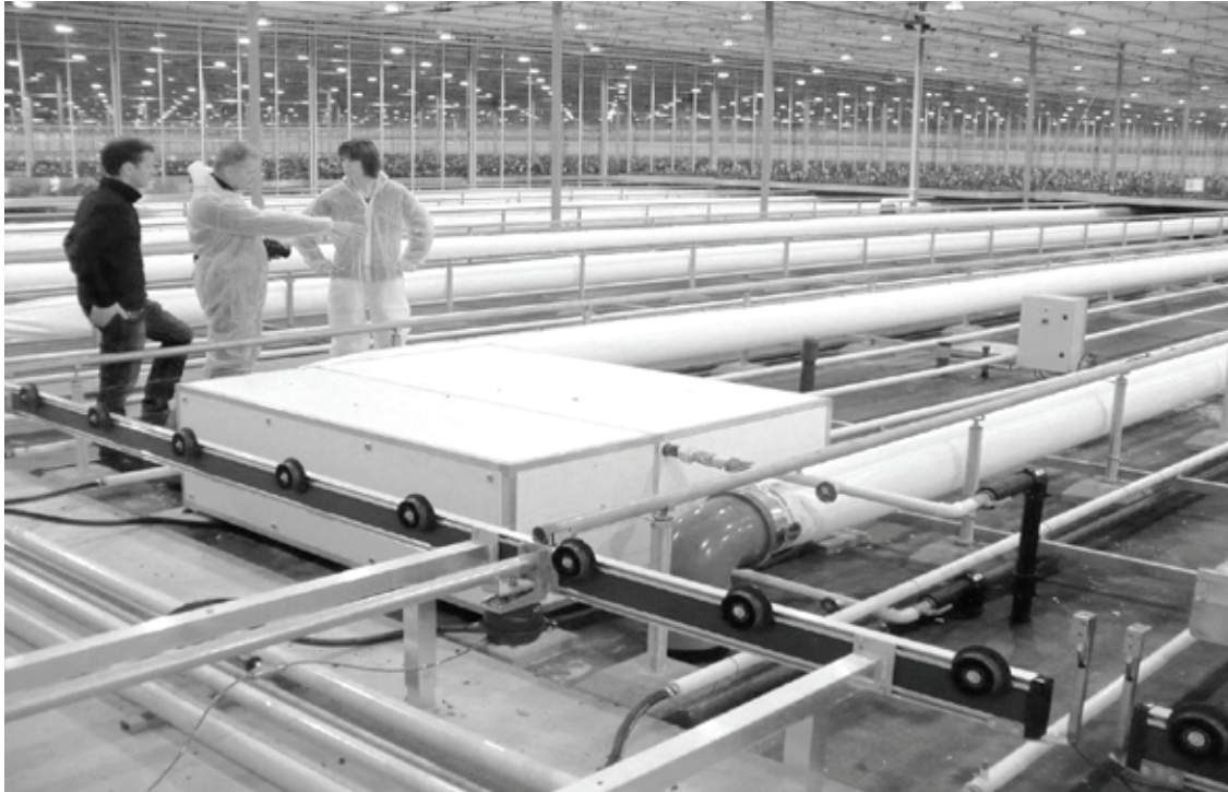
Figuur 2.1. Luchtbehandelingskast bij Opti-Flor waarmee droge buitenlucht wordt aangezogen die na opwarming tot de kasluchttemperatuur door de teeltafdeling wordt verspreid. Er staat 1 unit per 1500 m 2
