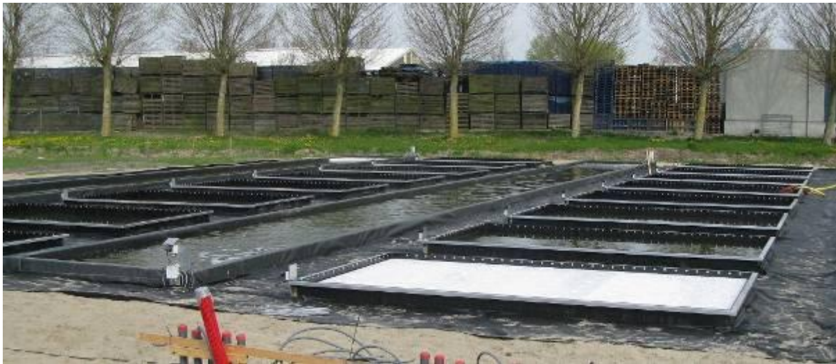
Foto 2.1: Impressie proefbassins Proeftuin Zwaagdijk in de aanlegfase 2010
