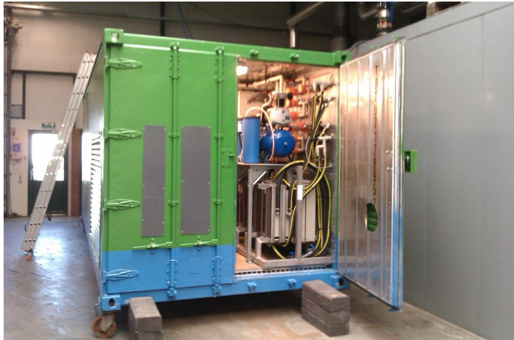
Figuur 5 Pilotinstallatie membraandestillatie tijdens installeren bij het glastuinbouwbedrijf
