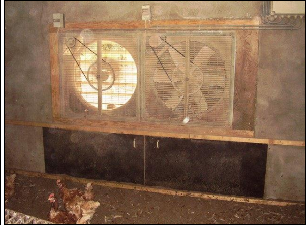
Twee kleine ventilatoren in de achtergevel van de proefstal
