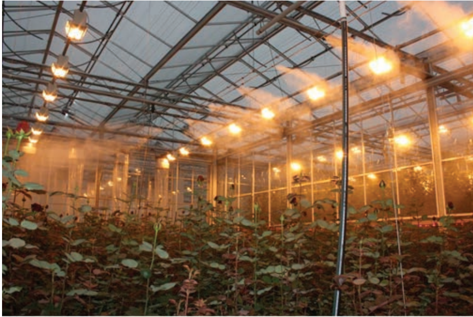
Figuur 5: Foto van de proefkas tijdens een vernevelingsbehandeling met het oxidatieve product. Hierop is goed te zien dat de nevel vooral in de vakken rechtvoor en linksachter terecht komt en dat er weinig drift is naar de referentievakken die met fungicide werden behandeld.
