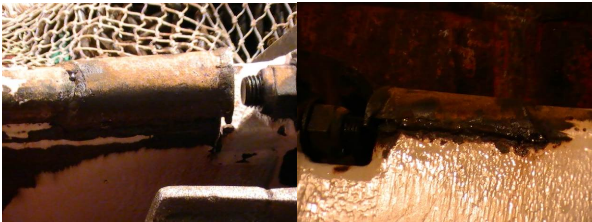
Figuur 23. Slijtage aan de lassen op de voorkant en slijtplate ter bescherming (GO-31).
