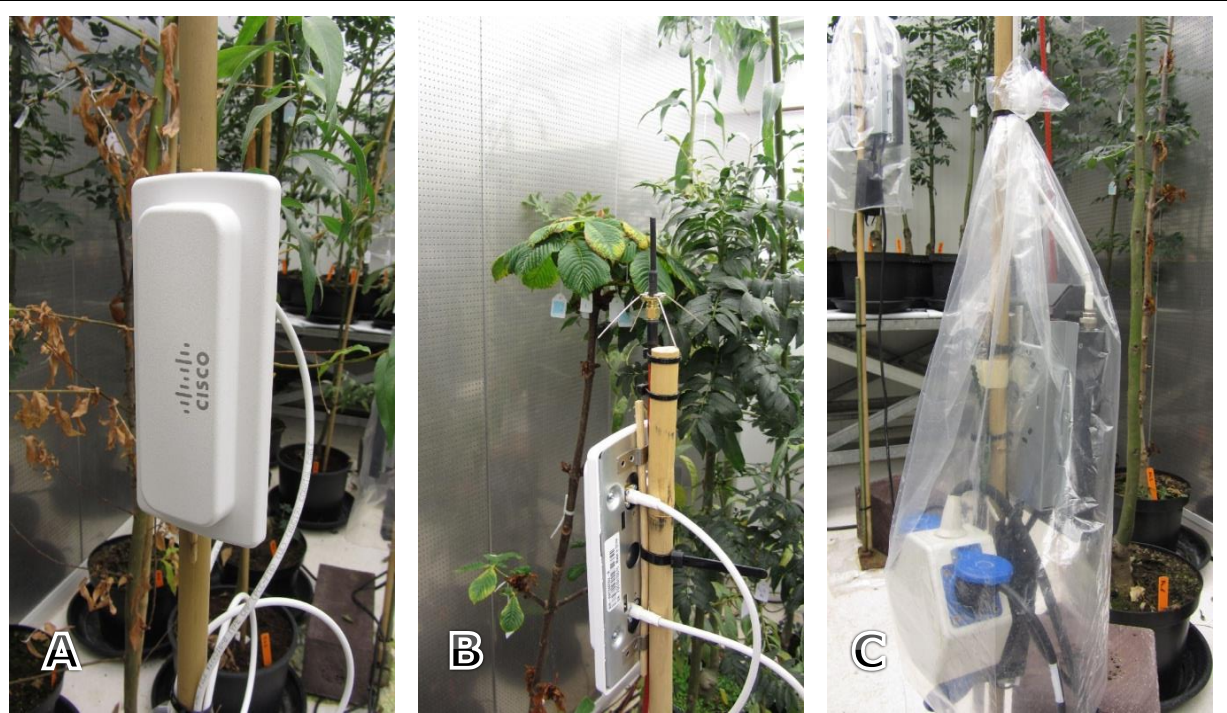
Fig. 20. Details WiFi apparatuur. A: WiFi-antenne-vooraanzicht, B: WiFi-antenne-zijaanzicht met UMTS-antenne erboven gemonteerd, C: WiFi-zender in plastic zak. Situatie 7-11-2012. IMG 5932, 5921, 5933
