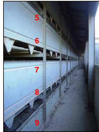
Gang aan de uitstroomzijde van de droogtunnel. Met nummers zijn de droogbanden aangegeven
