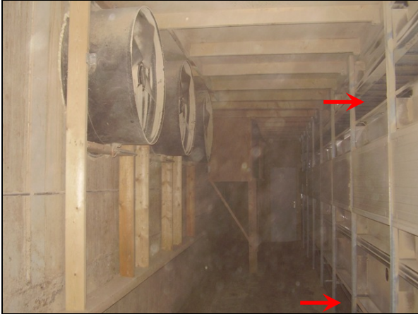
Binnenaanzicht van de drukkamer. Zichtbaar zijn drie van de vier drukventilatoren. Met twee pijlen is aangegeven waar de lucht de droogtunnel binnen wordt gestuwd
