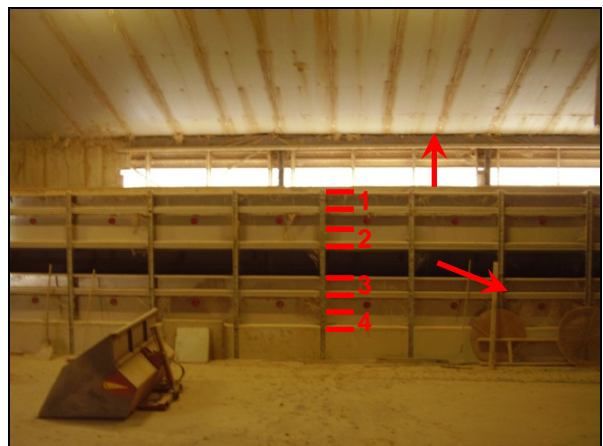
Voorraanzicht op de droogtunnel. Achter de droogtunnel (tussen zijgevel en droogtunnel) bevindt zich de drukkamer. De positie van de droogplaten is met 1-4 aangegeven. Zichtbaar is de open spleet in de zijgevel voor luchtuitleat van drooglucht naar buiten. Met pijlen is de uitstroom van drooglucht weergegeven
