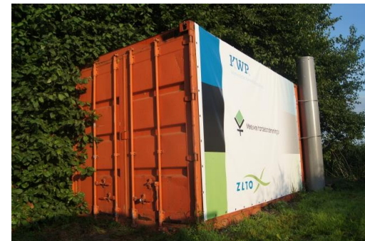
Fig. 9: Het bovengrondse ruimtebeslag van de Freshmaker: pompen en regelunit op de proeflocatie in Ovezande.
