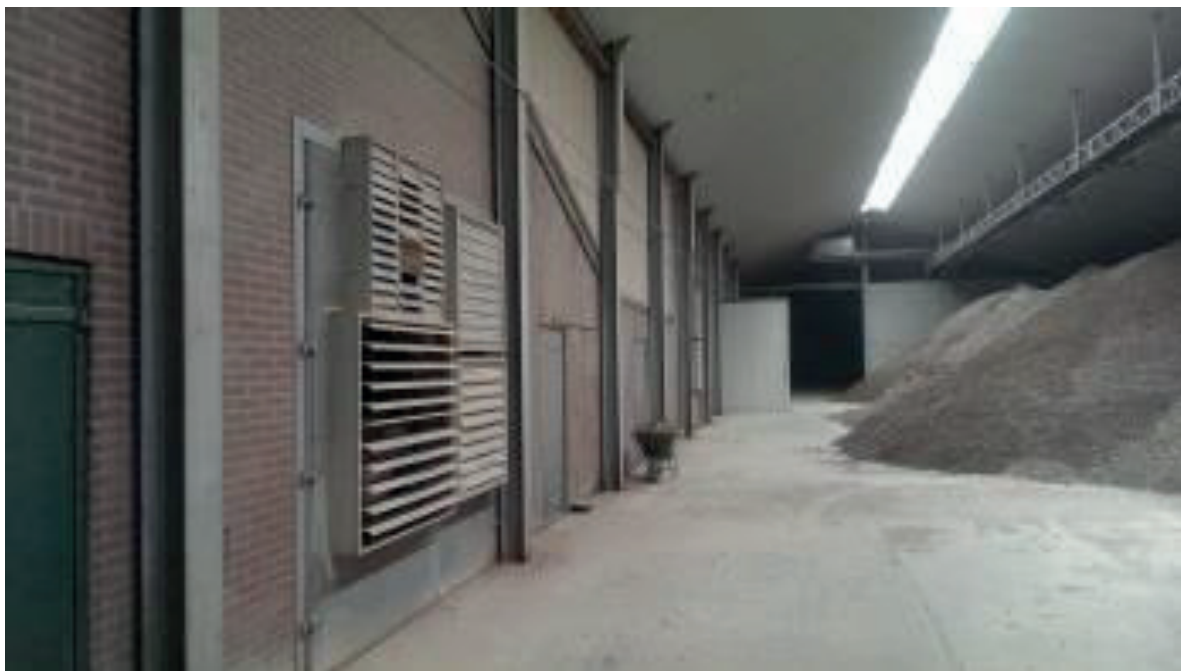
Figuur 13 Opslagloods voor de gedroogde mest op bedrijf 12. Achter de (lichtgekleurde) tussenwand staan de droogtunnels. Links de ventilatoren van een van de stallen.
